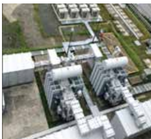
特別高圧受変電設備
