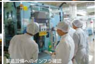
製造設備へのインフラ確認
