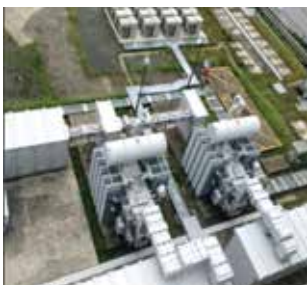
特別高圧受変電設備
