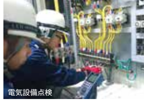
電気設備点検
