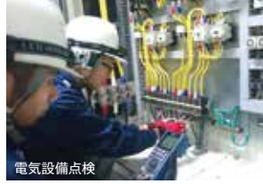
電気設備点検
